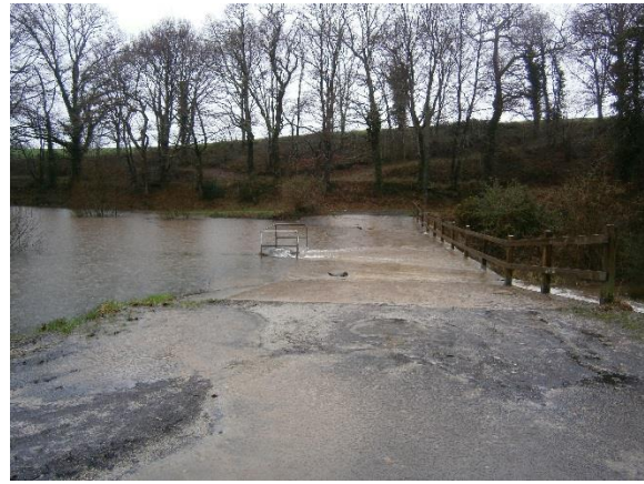
Photo 22 : Ouvrage de « Kerglancharde » sur le Dourdu lors de la crue de février 2014 (Ville Quimperlé, 11/02/2014)
