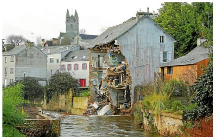
Une partie d'une maison de trois étages, située rue de Quimper, s'est effondrée dans l'Isolé, en 2018. Une conséquence de la montée des eaux brutale observée à Quimperlé lors de la tempête Dirk Le Télégramme/François Destoe
