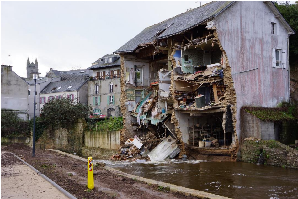
Photo 17 : Maison riveraine de l'Isle effondrée dans la nuit du 24 au 25/12/2013 (©Bernard Thomas, 26/12/2013)
